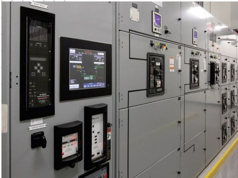
■ 第一線東京 POP 機房內部機電基礎設施一隅。
